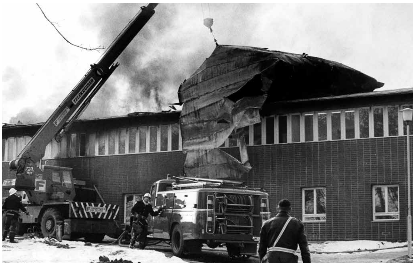
Brandkåren släckte snabbt lågorna, men arbetet med att helt släcka branden i undertaket tog längre tid. Yttertaget fick lyftas av och brandskadorna blev omfattande och kostsamma.
